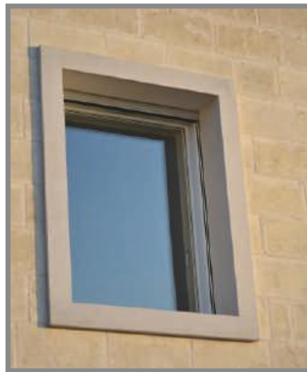
Vista esterna External view Vista exterior
